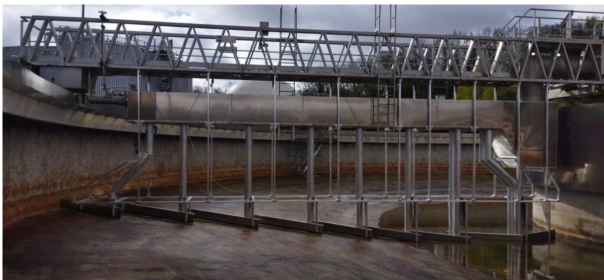
Ci-dessus clarificateur rénové
