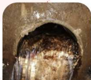
obstruction d'une grosse arrivée d'eau
