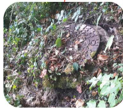
Regard dans le coteau inaccessible obstrué par des racines
